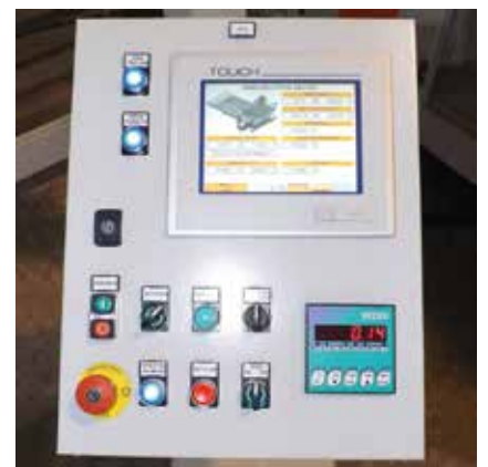
Pannello di comando Control panel board
